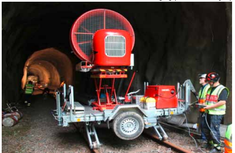
Abb. 5: Lüfter im Tunnelleingang (Foto: METRO-Projekt)
